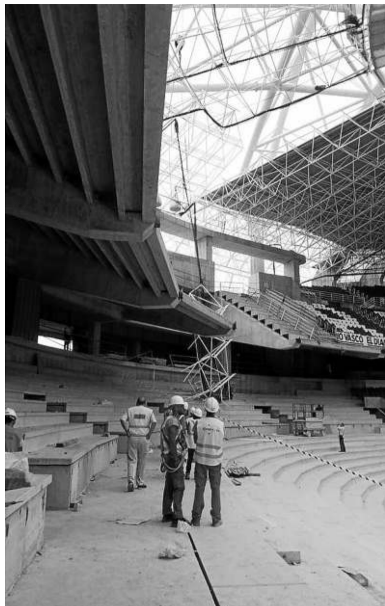
Operarios en el lugar del accidente junto a la estructura rota. Foto: N.G.
